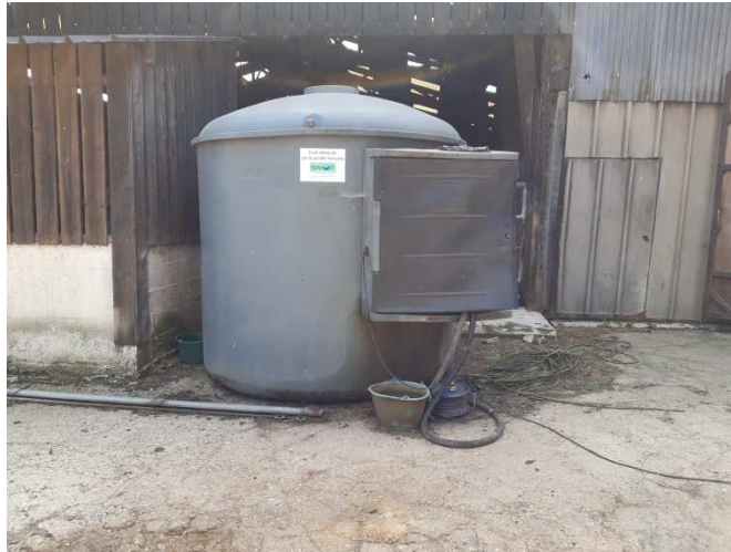
Cuve à fioul
